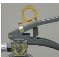
× 安全栓の抜けかけ
