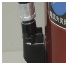
× 消火薬剤の漏れ
