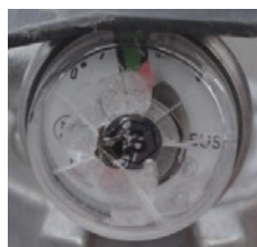
× 指示圧力計の損傷
